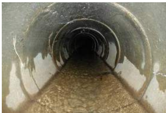
FIG. 21 : Réseau pluvial sous le boulevard Henri LACLAU
