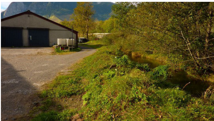
◄ Domaine de Carolle, 2014 [46] : vue de l'aval sur le léger endiguement en levée de terre le long du bras de décharge, dans la prolongation des digues. En arrière plan, la déviation et l'ouvrage de franchissement du remblai routier pour les écoulements en forte crue (Photographie AlpesGéoConseil).
