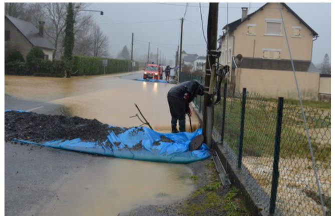
▲ Bas du quartier de Berthoumieu 25/01/2014 [32]: évacuation sur le pré en aval, déjà inondé par l'Aricq de Yes, et installation d'un bourrelet de matériaux pour éviter une propagation des eaux au-delà du carrefour de l'ancienne route nationale et de la rue de la Croix d'Orcun. (Photographie d'un riverain).
