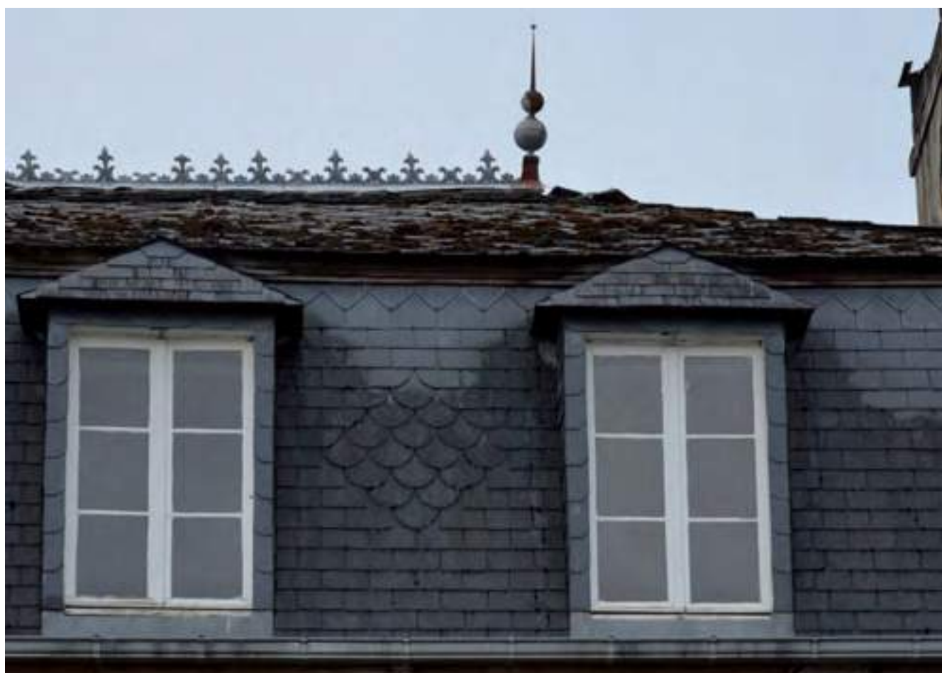
Lucarnes en bâtière sur le brisis d'un toit à la Mansart. Décor d'ardoises taillées en écailles de poissons dans un losange entre les deux lucarnes et épi de faîtage et faîtière en zinc découpé. Lasseube.
