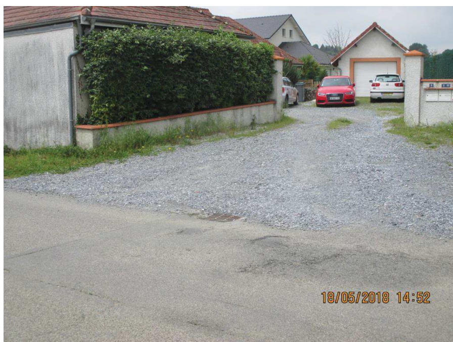
Fig. 15. Affaissement autour de la grille – Chemin du stade
