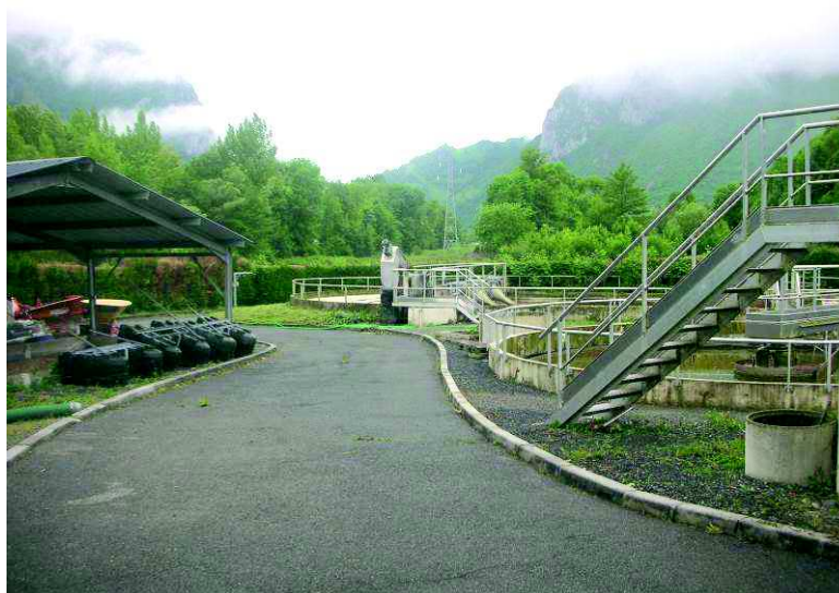
Station d'épuration de Lees
