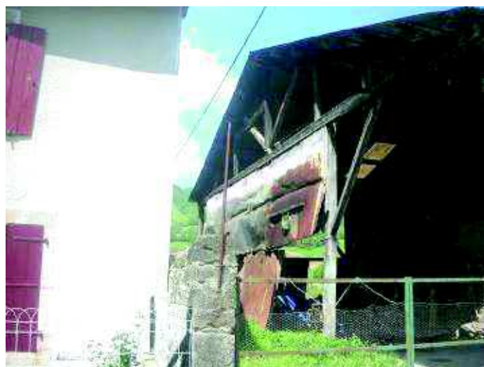
Bâtiment dégradé à Suberlaché
