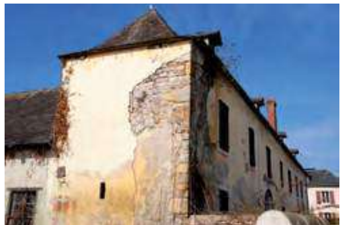
Enduit dégradé laissant apparaître le chaînage d'angle et la composition du mur. Préchacq-Navarrenx.
