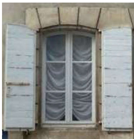
Fenêtre XVIII e siècle, partition à grands carreaux, volets en planches et contre-planche qui s'inscrivent dans la feuillure de l'encadrement.
