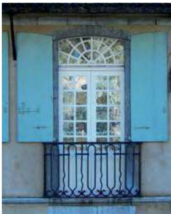
Demi contrevents pleins sur une porte fenêtre et partition à petit carreaux de l'imposte rayonnante et de la fenêtre. Les contrevents épousent la forme incurvée de de la partie supérieure de l'encadrement. XVII e - XIX e siècle.
