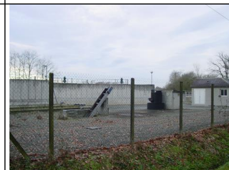
Station d'épuration (quartier de Berlanne)
