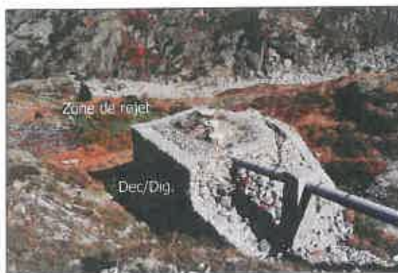
décanteur/digesteur du lac d'Artouste
