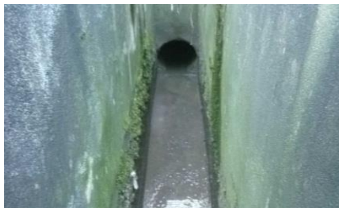
Figure 26 : STEP / Vue sur le canal venturi du By-pass
