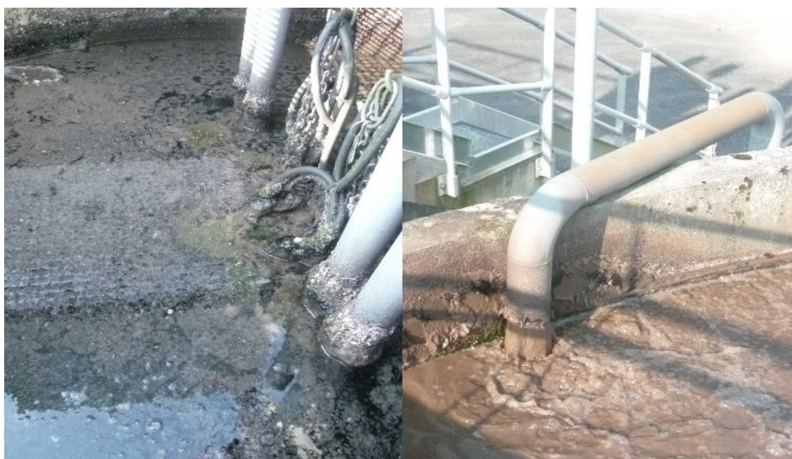
Figure 33 : STEP / Vue sur le puits de recirculation et sur la sortie au niveau du bassin d'aération
