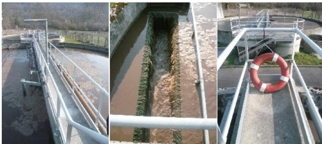
Figure 29 : Vue sur la passerelle du bassin d'aération ainsi que sur déversoir de réoxygénation
