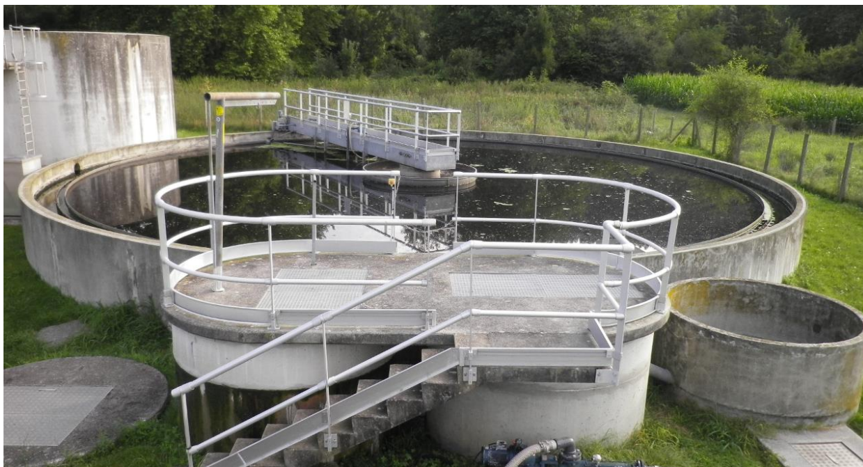
Figure 30 : STEP / Vue sur le dégazeur
