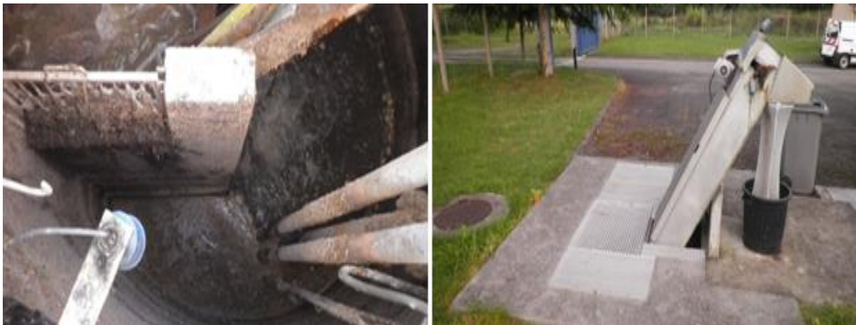
Figure 27 : Vue sur le poste de relevage et le dégrilleur automatique
