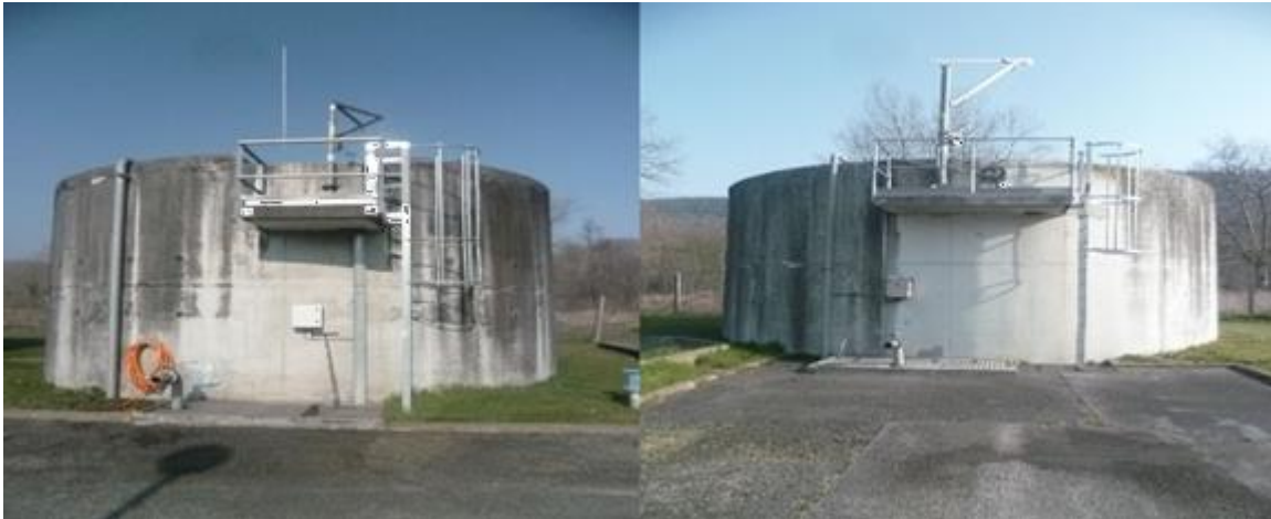
Figure 34 : STEP / Silos de stockage / En haut à gauche : Silo 1 ; En haut à droite : Silo 2
