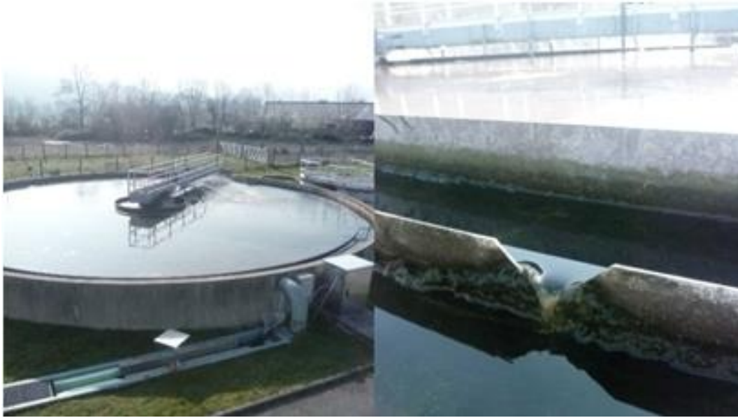
Figure 31 : STEP / Vues sur le clarificateur
