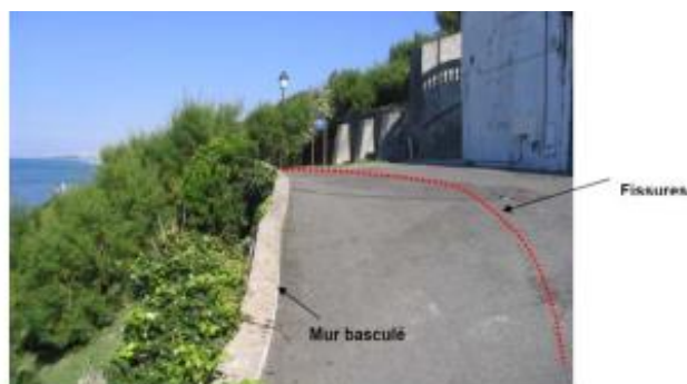
Figure 26 : Fissurations et désordres affectant le sommet de versant (Aubié et Mathon, 2006b).
