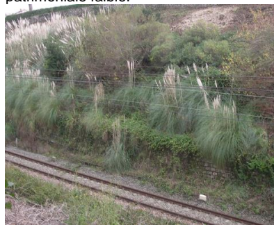
Invasives le long de la voie ferrée
