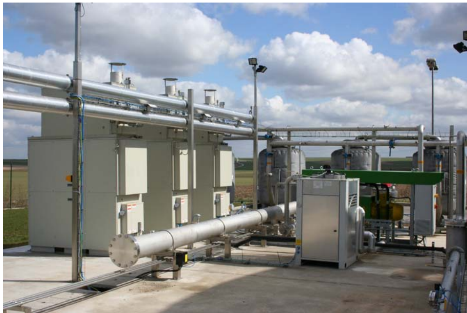
PHOTO N°5 : PLATEFORME DE PRODUCTION D'ELECTRICITE/BIOGAZ
