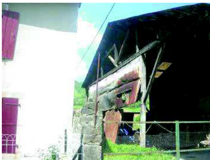
Bâtiment dégradé à Suberlaché
